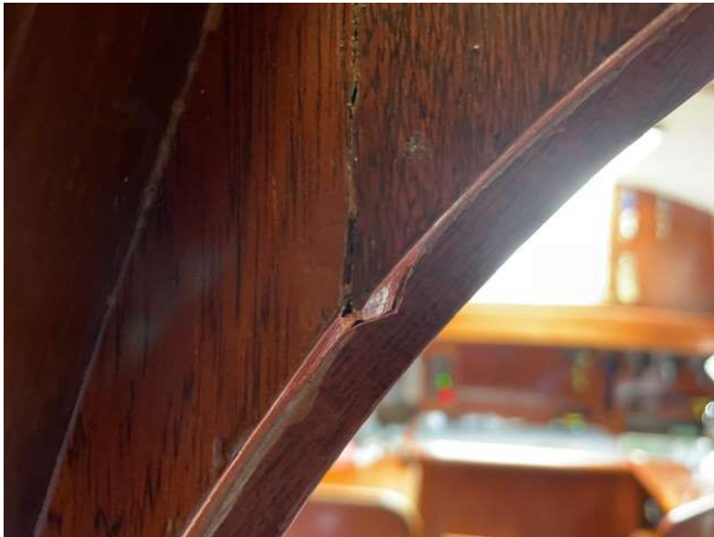
Schade aan stuurboordzijde van hoofdschot door de verzakking
