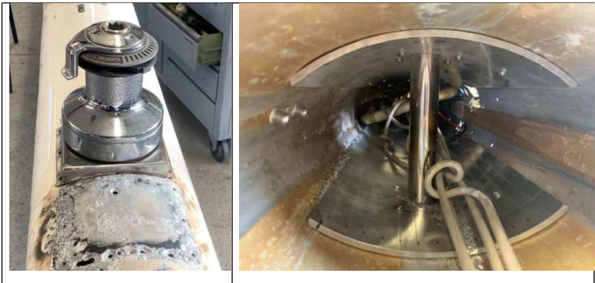
Corrosie onder mastlier en reparatie met inlegplaten
