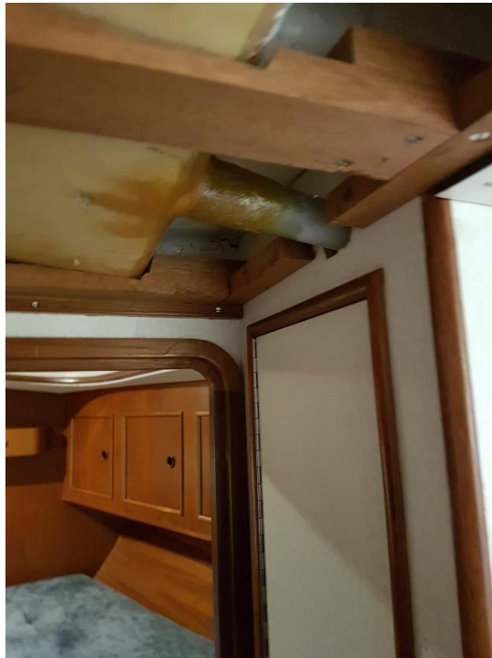
Aansluiting op de kuipafvoer aan BB zijde
